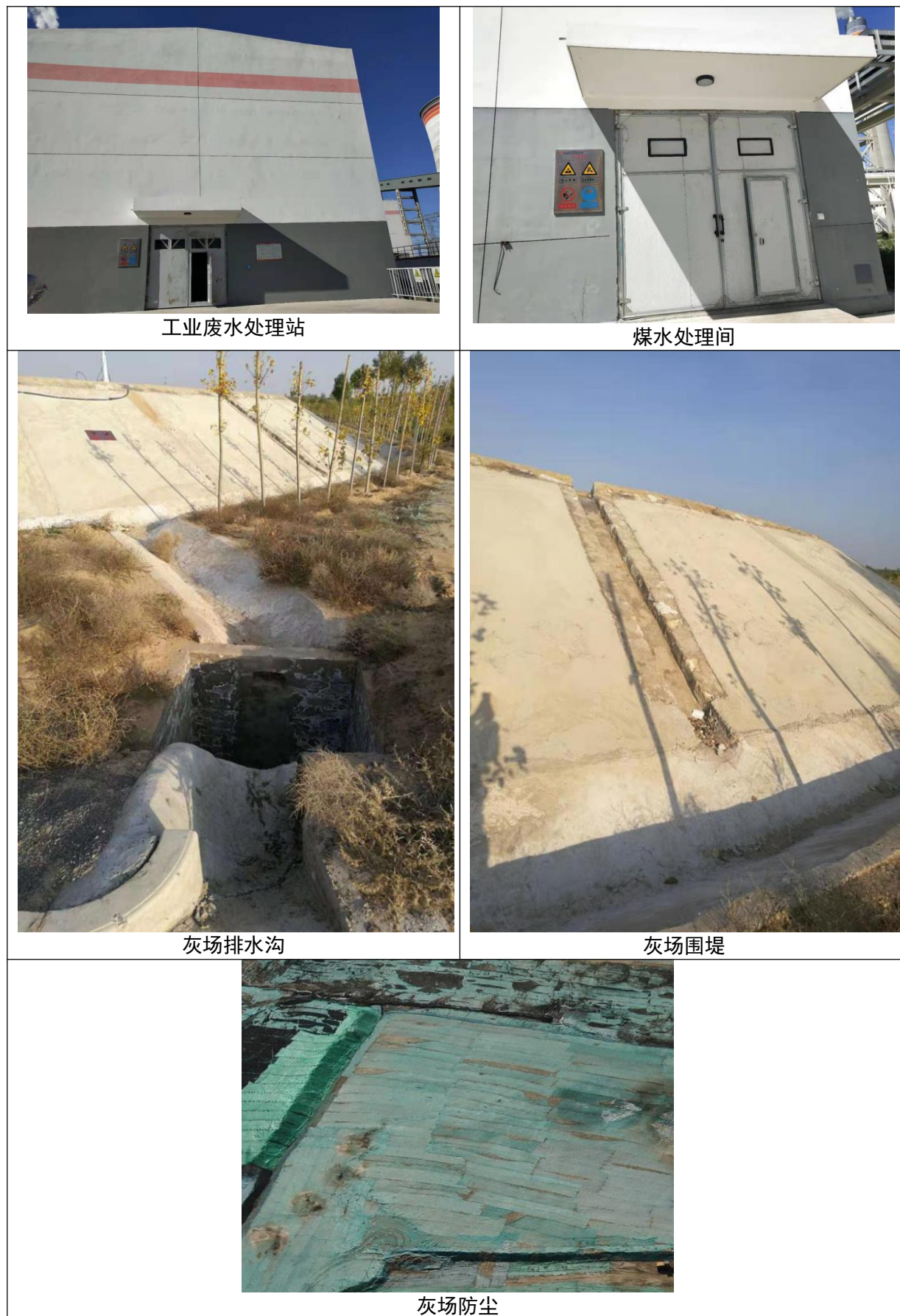
图 3.1-6 一期工程主要环保设施现状照片
